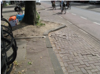
Schade aan bestrating door wortels.
